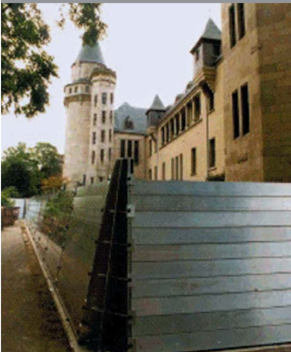
Mobiler Hochwasserschutz mit Dammbalken
